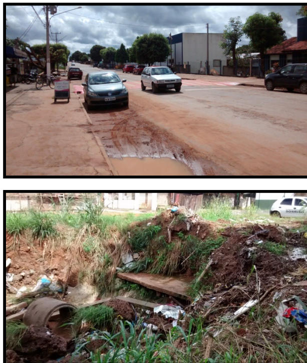
Foto 10 - Vista típica do assoreamento de vias e dispositivos de drenagem - Detalhe para erosões e acúmulo de resíduos em área de corpo hídrico
