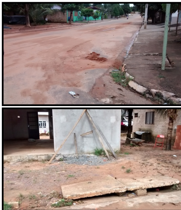
Foto 3 - Vista típica do assoreamento de vias e dispositivos de drenagem - Detalhe para rede sob edificação
