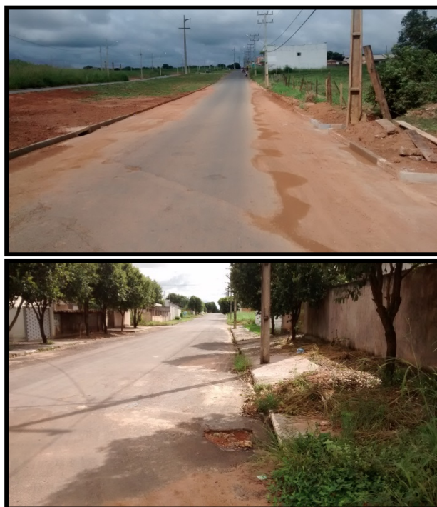
Foto 1 - Vista típica do assoreamento de vias e dispositivos de drenagem - Detalhe para o desgaste na pavimentação decorrente do deflúvio superficial
