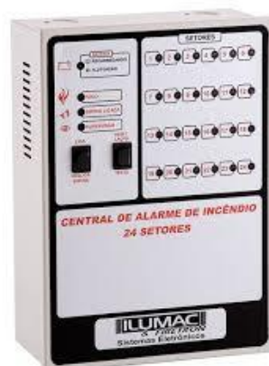
Figura 13 – Central de Alarme de Emergência
