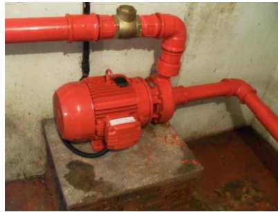
Figura 17 - Bomba de Incêndio
