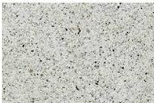
Piso granilite com cimento branco
